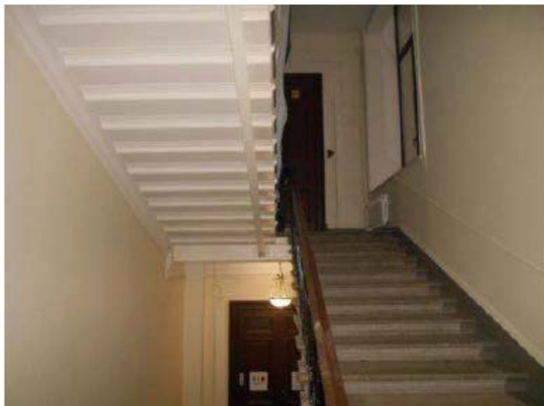
Фото 6. Техническое состояние подьезда
